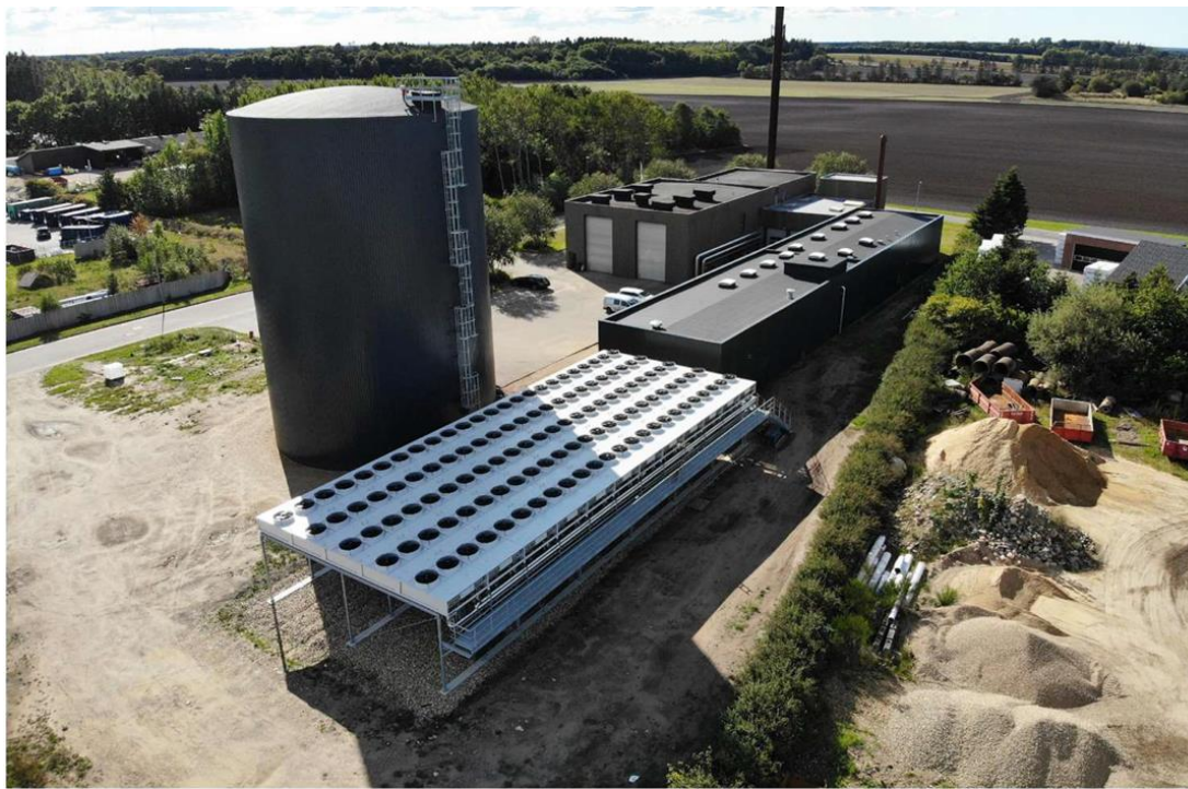
Obrázek 37. Instalace o výkonu 3,3 MW v Sonder Felding, Dánsko (zdroj FENAGY)
